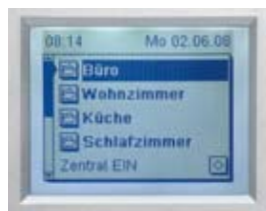
MCC für die Überwachung und Steuerung von Schaltungen, Jalousien, Temperaturanzeige
